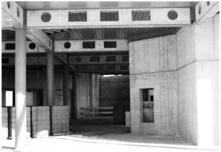
Bild 5. Deckenfeld und Träger mit großen Aussparungen
